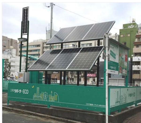
ハイブリッドソーラーシステム・ソーラーLED街路灯・排ガス対策用パネル
